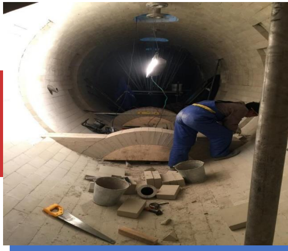
Футеровка кислотостойкими кирпичами в автоклаве
