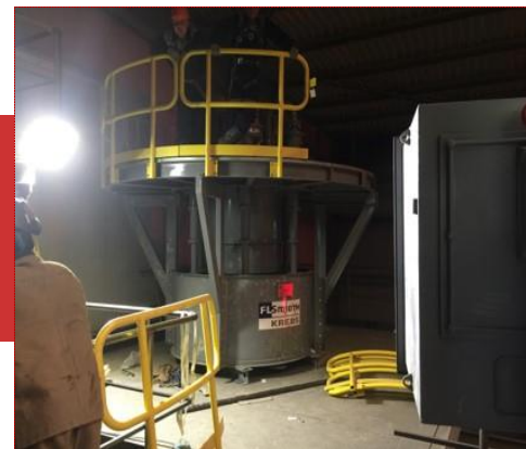
Установка гидроциклонов и редукторов, двигателей
